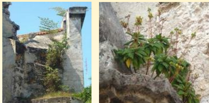
Fig.2 Desarrollo avanzado de especies arbustivas sobre muros exteriores de edificaciones históricas como en el Convento de San Francisco de Asís y la Catedral de la Habana.
